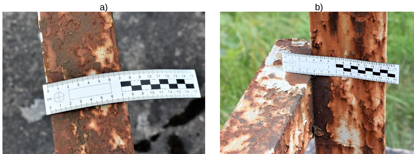
Ilustracja 3. Stan powłok malarskich elementów poręczy: a – stan pochwyty; b – stan słupka i wypełnienia
