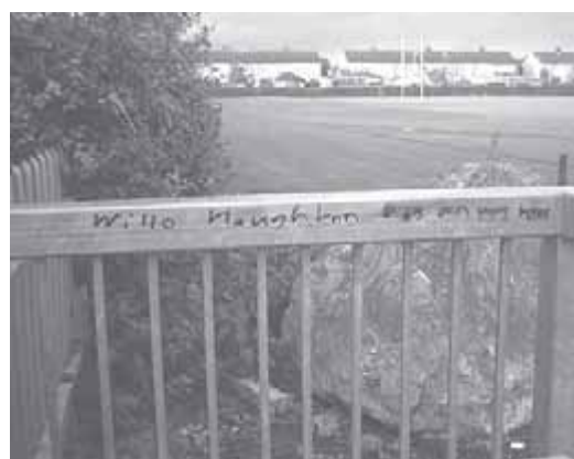
D. Barieroporcze z licznymi napisami i nielicznymi śladami korozji.
