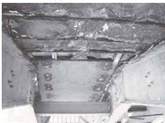
C. Skorodowane, z licznymi ubytkami trepy schodów.
