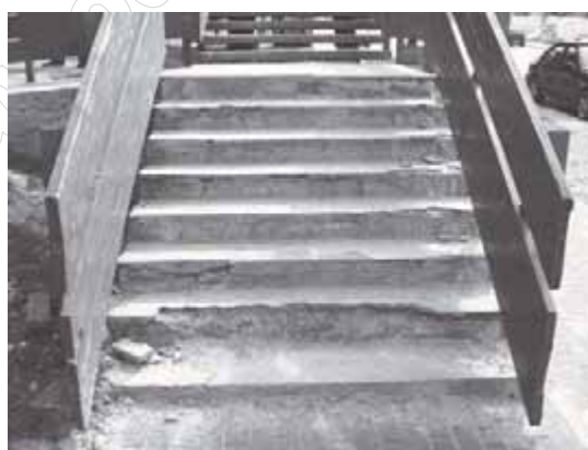
B. Schody z licznymi ubytkami korozyjnymi.
