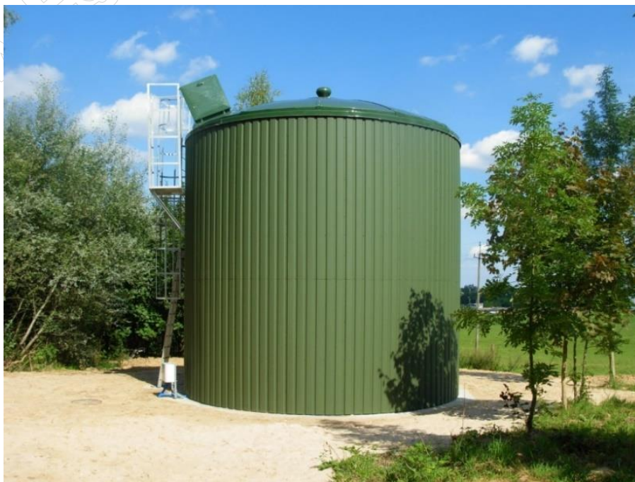
Rysunek 1. Widok zbiornika retencyjnego wody czystej
