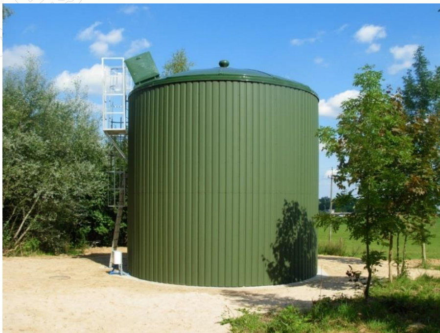
Rysunek 1. Widok zbiornika retencyjnego wody czystej
